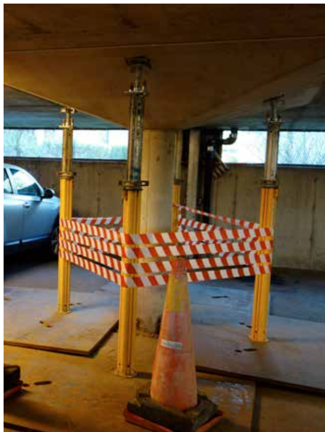
Vissa pelare i garaget är i så dåligt skick att det behövs stämopor för att avlasta dem.
